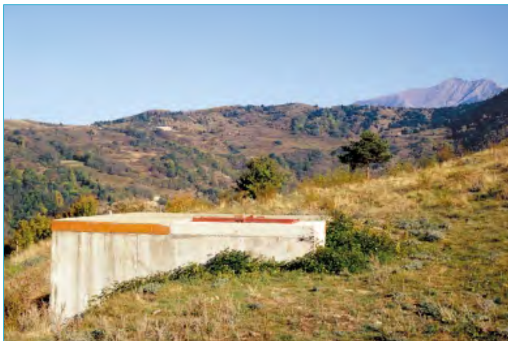
Des équipements de protection ont été installés : ici, réserve d'eau.
